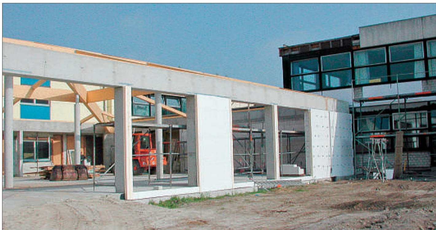
Im Frühjahr des kommenden Jahres wird das Mensagegebäude der Hauptschule Norden fertig sein. FOTO: KRUSE
