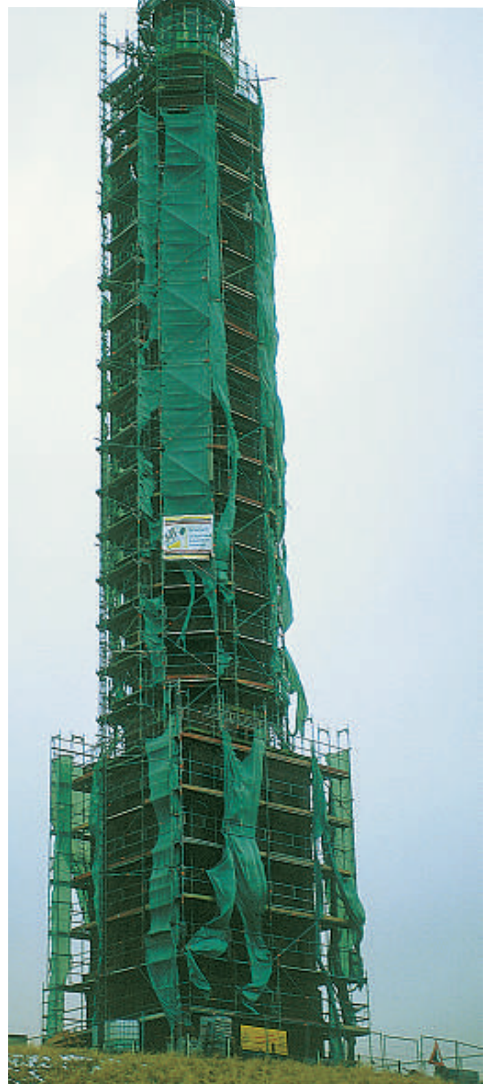
Christo auf Norderney. Nur noch wenige Tage ist der Norderneyer Leuchtturm verhüllt, dann werden Gerüst und Folie zum Teil wieder entfernt – zwei Drittel der Sanierung sind beendet. FOTO: STROMANN
